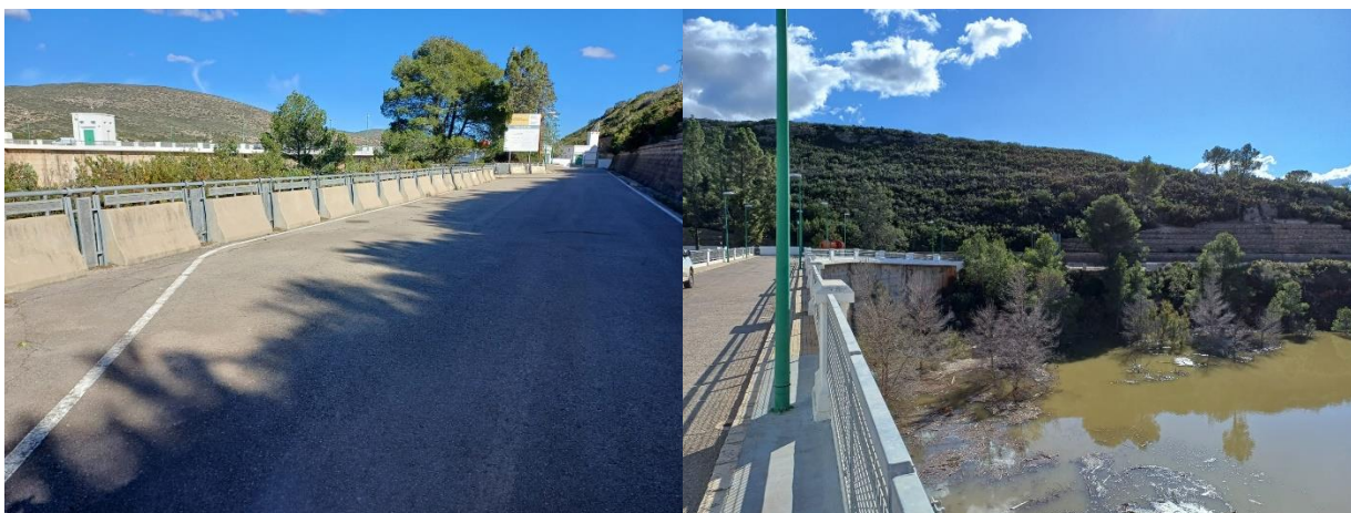
Figura 14. Vista del camino de acceso a la Presa desde la margen derecha. La imagen de la derecha está tomada desde la coronación de la Presa. Se aprecia su inferior cota y la rampa que permite el acceso a coronación desde el propio camino. El desnivel es de más de 2 metros.
