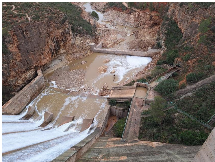
Figura 7. Vista general de la zona aguas abajo de la Presa de Forata. Se aprecian los daños en el contraazud, el cuenco amortiguador, la ladera en la margen izquierda del propio cuenco y la ladera frente al azud, por la que discurre en túnel del primer tramo del Canal del Magro.
