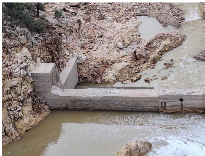
Figura 8. Destrucción de unos treinta metros del labio superior del contraazud, en una altura aproximada de 3 metros.
