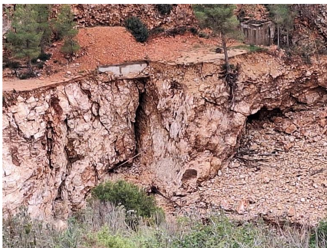
Figura 12. Vista desde la margen izquierda. Fábrica del túnel del Canal descalzado.
